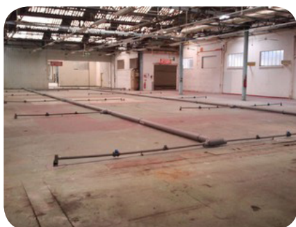
Réseau d'extraction d'air au sein de l'ancienne usine JPM
