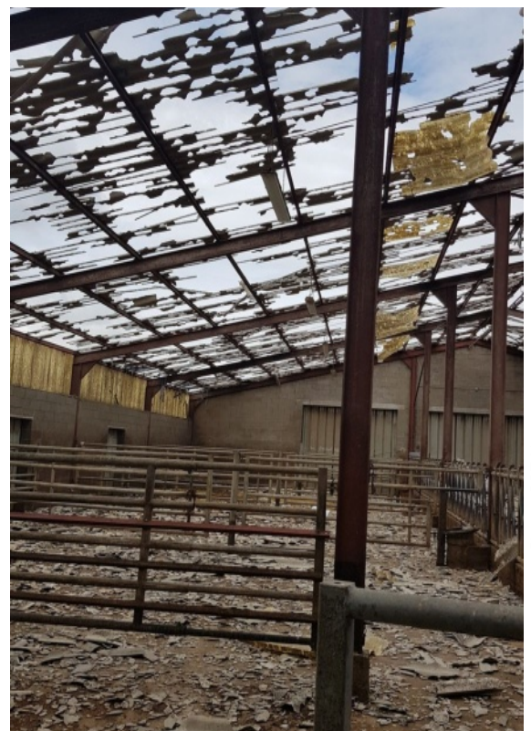
Bâtiment agricole sinistré par la grêle
