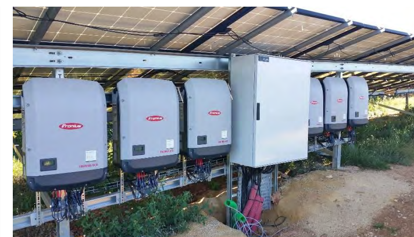
Boîte de jonction, onduleurs et câbles à l'arrière des panneaux -
