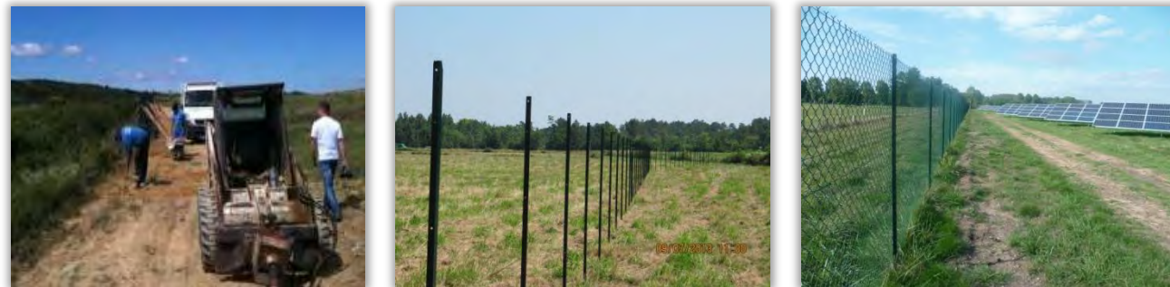
Mise en place de la clôture : pose des ancrages, des piquets et du maillage – Source : LUXEL 2010-2011-2013
