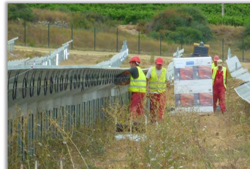
Câblage et interconnexion des modules photovoltaïques – Source : LUXEL, 2010
