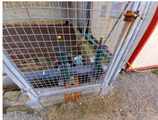
Photographie du système de pompage entre la fosse rectangulaire ST02B et la fosse circulaire ST03B
