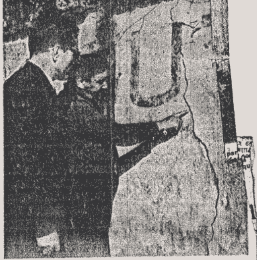
M. Péon, de Limons, montre à M. Dessens une fissure de plusieurs millimètres.
