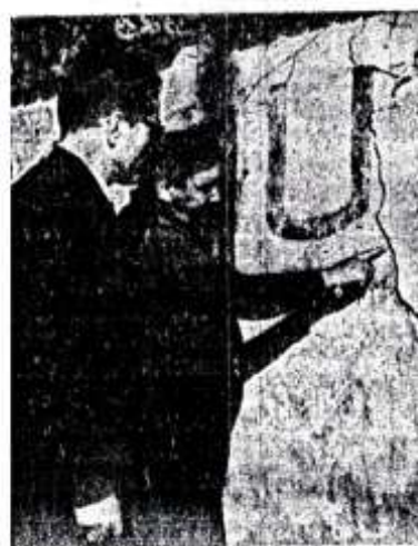
M. Féon, de Limons, montre à M. Dessens une fissure de plusieurs millimètres.
